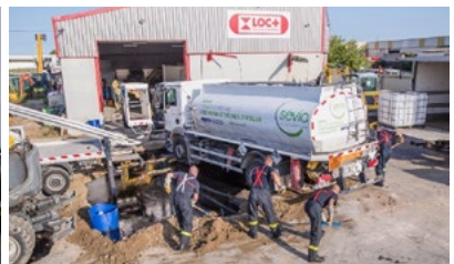
Fuite produits chimiques dans vanne pompage citerne à Perpignan, 2020.
