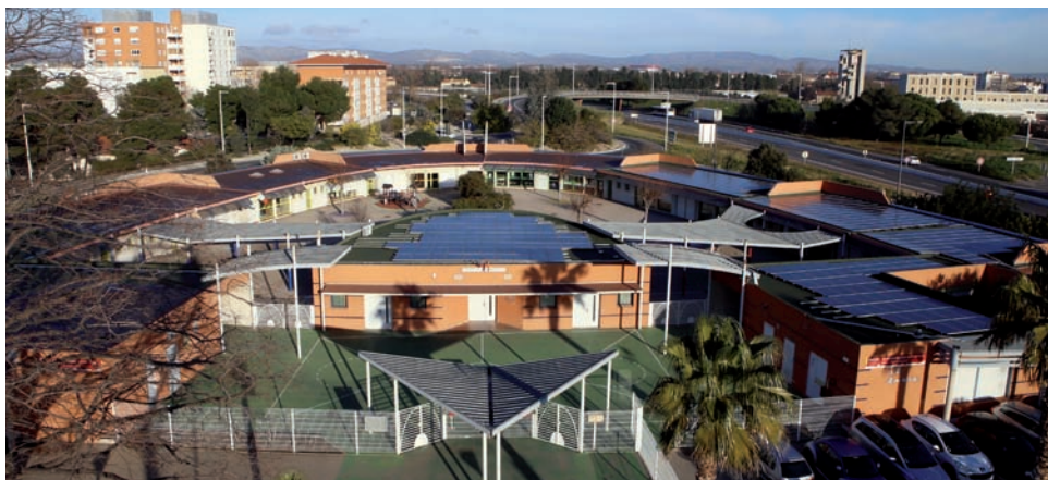
Toiture solaire : Ecole Pont Neuf
