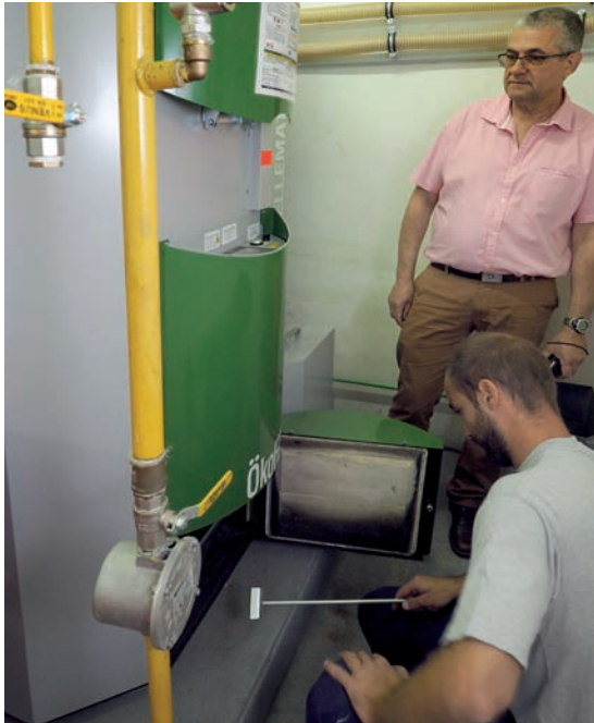
L'école Dagneaux équipée d'une chaudière à granulés dans le cadre du CPE
